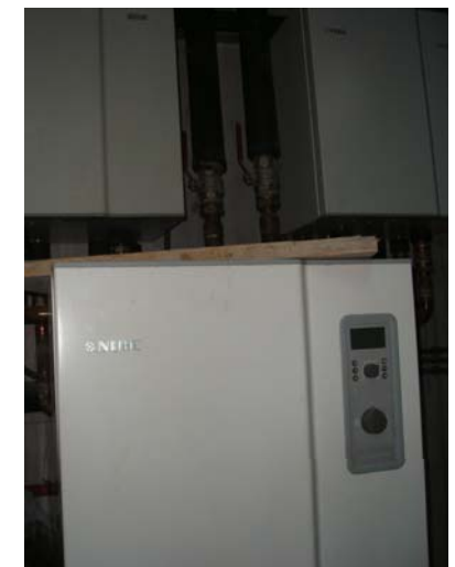
La bomba de calor Nibe i els HPAC.
