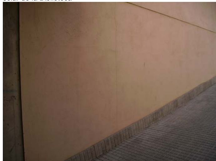
Petita fissura observada al revestiment de la rampa.
