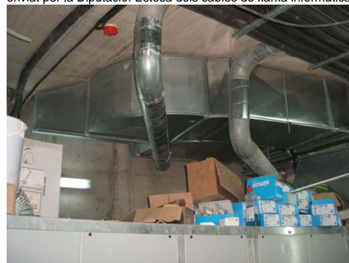
Visió de la sala del climatitzador de l'ala Sud. A l'esquerra el retorn de l'aire de les plantes superiors. Després l'admissió d'aire, i al fons un tub obsolet. Als dos últims es connecten les ventilacions de la sala d'electricitat.
