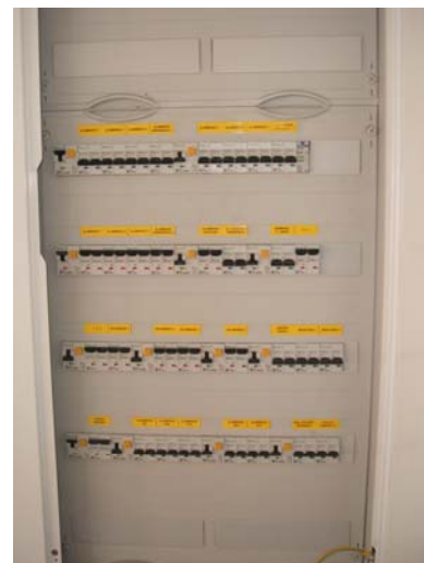
Detall del quadre elèctric de planta baixa.
