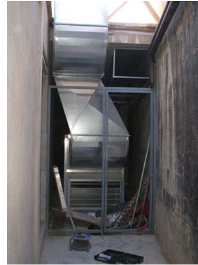
Admissió d'aire del condicionador de l'ala Nord, i sortida d'aire del de l'ala Sud.
