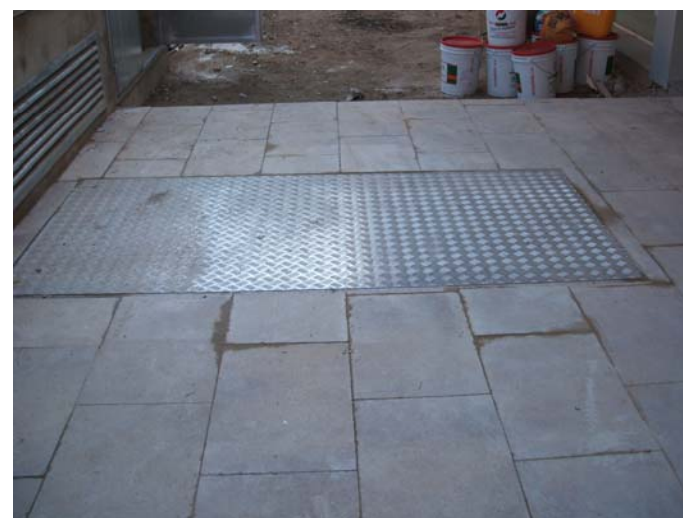
Tapa del generador. Per a reparacions o substitucions. Amb desguàs propi.
