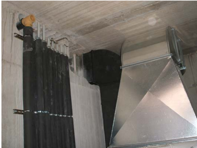
Sala d'aire condicionat de l'ala Nord. Connexió al fals sostre de la sala polivalent.
