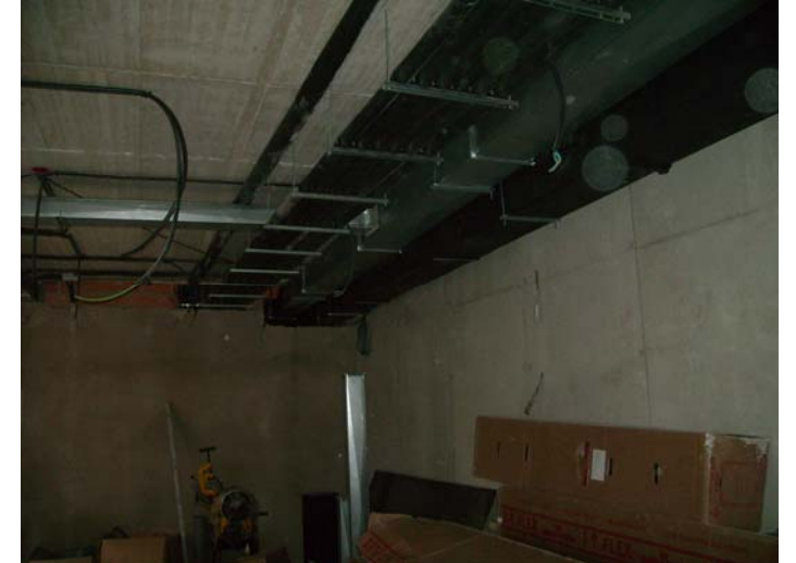
Instal·lacions al sostre de la sala de personal.
