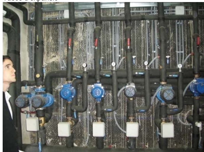
Bombes del sòl radiant
