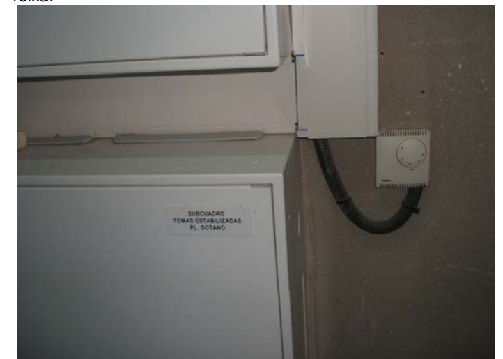
Quadre de preses estabilitzades al recinte de quadres elèctrics. Termòstat de la ventilació del recinte elèctric.
