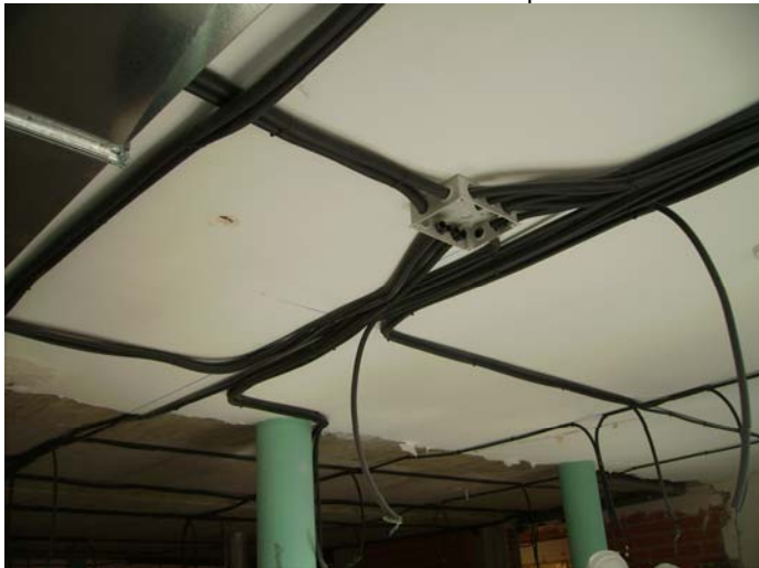
Sostre de planta baixa. Biblioteca antiga. Instal·lacions elèctriques.
