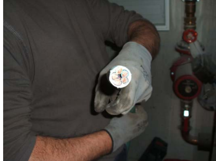
Cable d'alimentació elèctrica de la bomba geotèrmica aigua/aigua Nibe.
