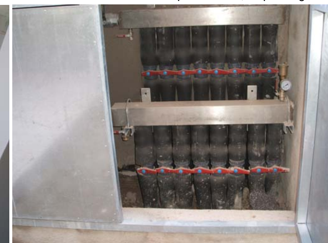
Armari dels col·lectors dels pous geotèrmics.
