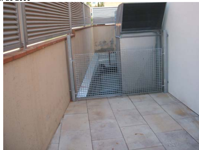
Barana sobre el pati, a l'ala Nord. Tub d'admissió del climatitzador de l'ala Nord.
