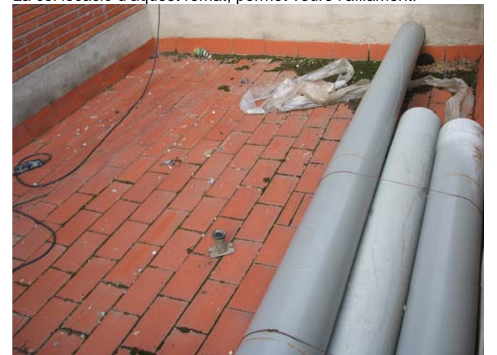
Està en mal estat, i permet el pas de les humitats. Es decideix impermeabilitzar-la, i donar-li el mateix acabat que l'edifici nou: Coberta invertida amb capa de protecció de palet de riera.
