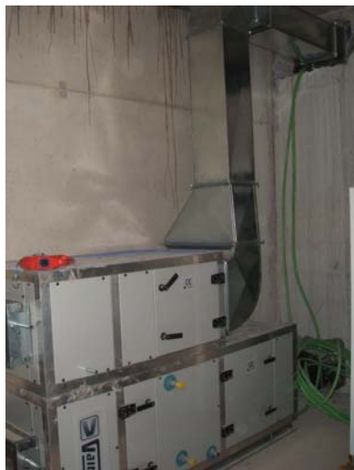
Sala de caldera i de la bomba geotèrmica. Aparells d'aire condicionat de la sala polivalent.
