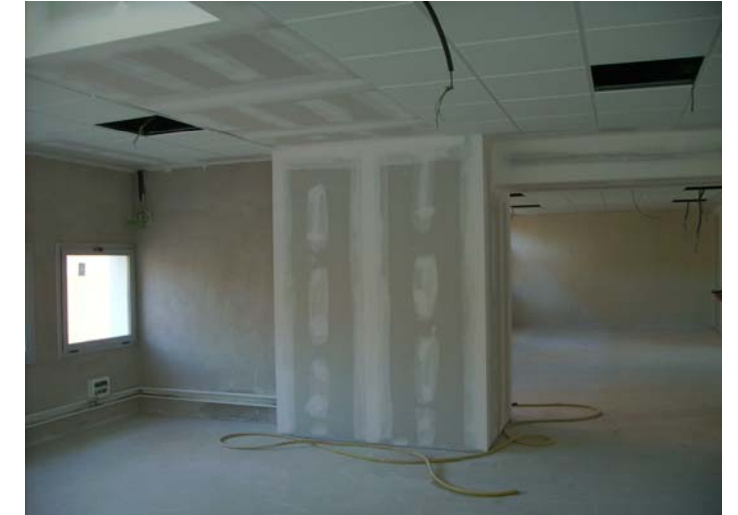
Cambra d'instal·lacions al primer pis de l'ala Nord.
