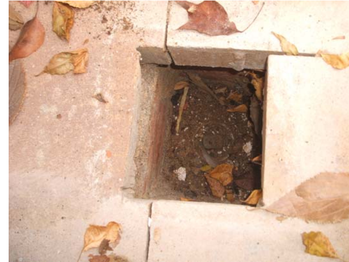
Arqueta de la clau de gas de la companyia
