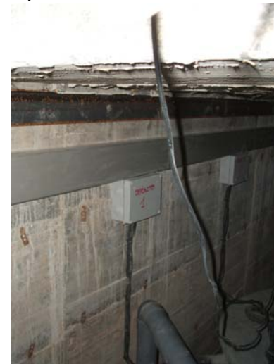
Instal·lacions elèctriques de la cambra dels dipòsits de sanejament.
