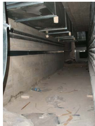
Sortida del tub d'evacuació d'aire del climatitzador de l'ala Sud, cap al pati de l'ala Nord.
