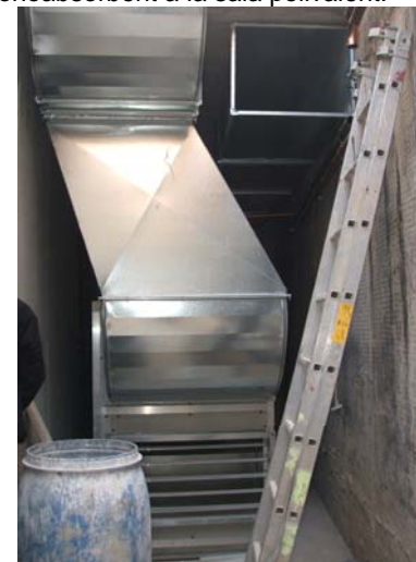
Nou tub d'admissió d'aire de l'aire condicionat de l'ala Nord. Tub d'expulsió d'aire de les dues màquines d'aire condicionat (ala Sud i Nord)
