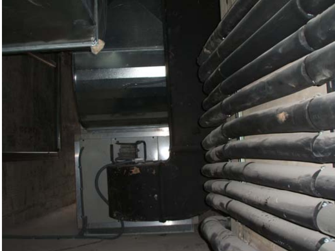
Vista del túnel entre ales, Al fons, el recinte del climatitzador de l'ala Nord.
