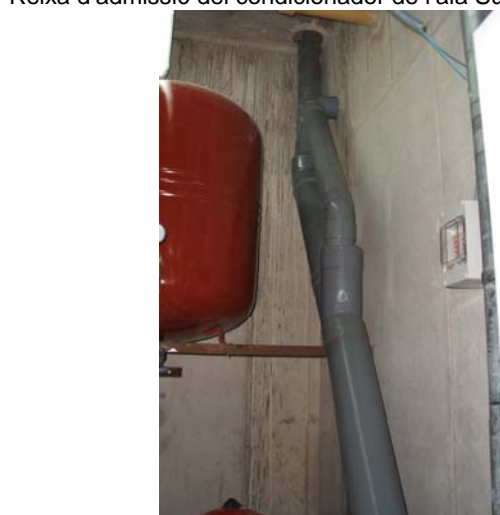
Desguàs del paviment superior, i del sobreeixidor del dipòsit d'aigua per a incendis. Dipòsit d'expansió de la climatització.
