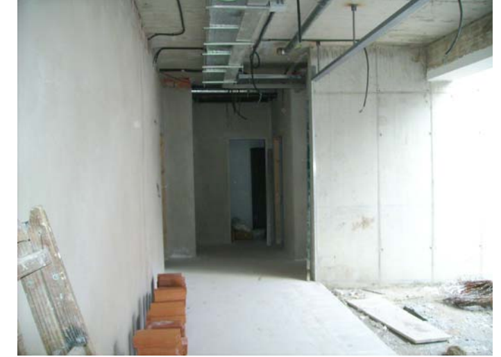
Instal·lacions elèctriques i contra els incendis a la planta soterrani.
