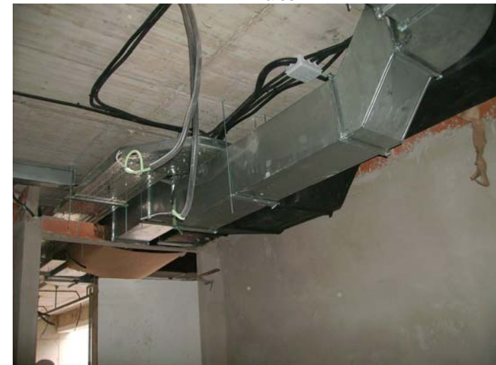
Instal·lacions d'aire condicionat i elèctriques al sostre del despatx
