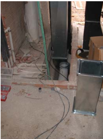
Pas d'instal·lacions d'aire condicionat, ventilació de lavabos del soterrani i del sanejament. (Planta baixa)
