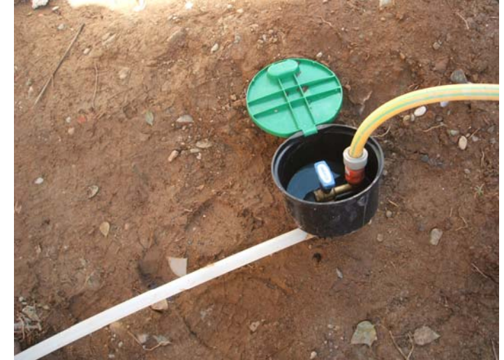
Arqueta de rec del pati Nord.
