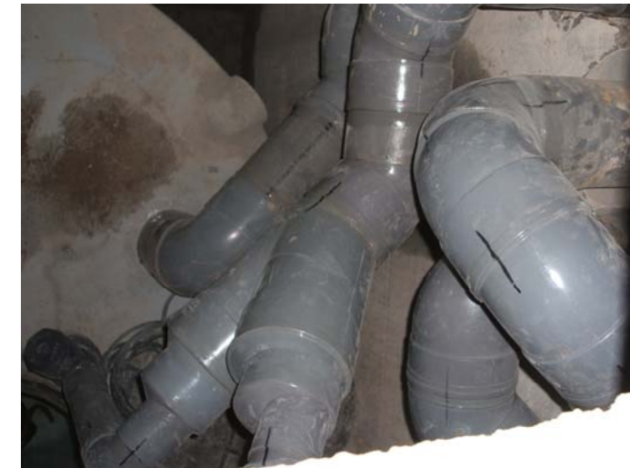
Ultim dipòsit (fecals)(extrem Sud) Connexions al tercer dipòsit: D'esquerra a dreta: Pluvial connectat a fecals. Sortida Fecals 1, sortida fecals 2.Sortida pluvials dipòsit 2.Sortida pluvials dipòsit 1.
