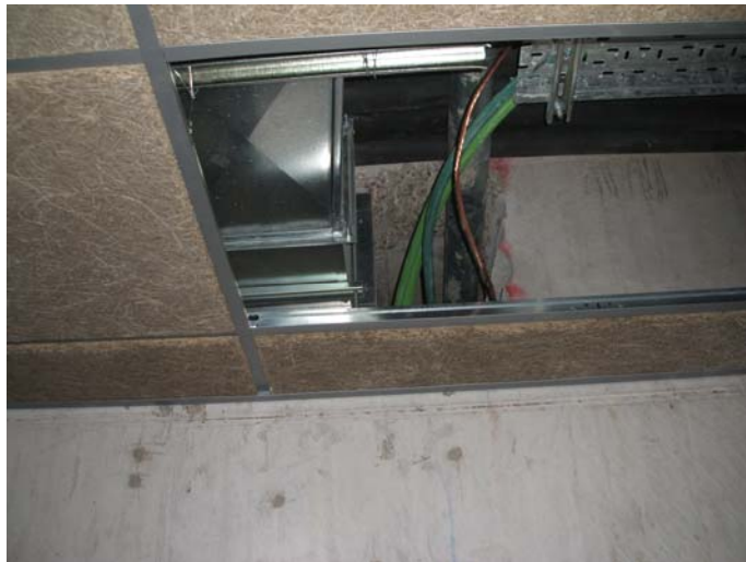
Pas d'instal·lacions d'aire condicionat des de la sala polivalent, a la sala de climatitzadors de l'ala Nord.
