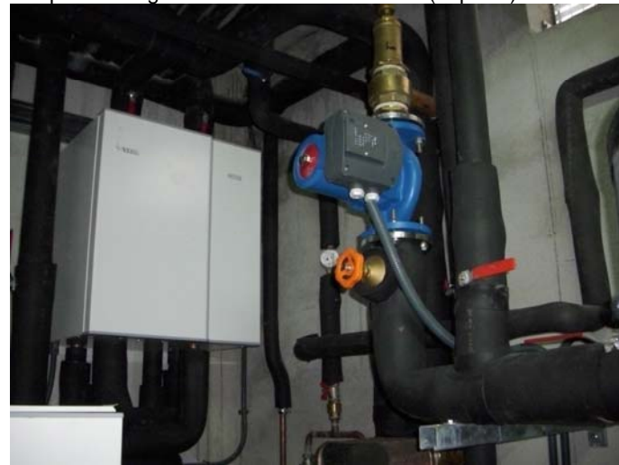
Bomba de la geotèrmia.
