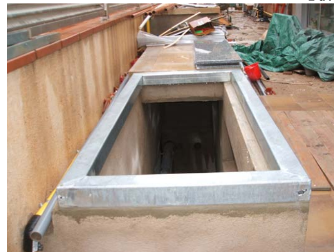
Marc de la tapa d'entrada al generador. A l'esquerra, el tub del gas.
