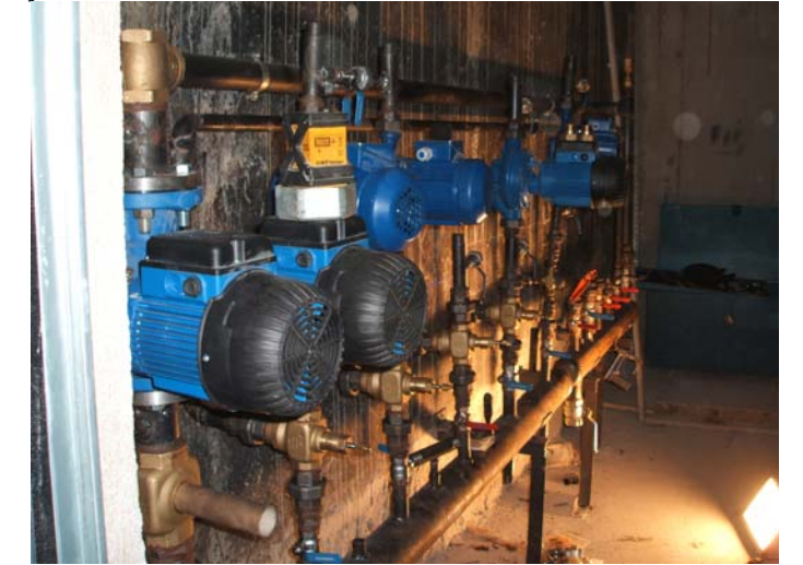
Col·lectors de l'aire condicionat i terra radiant.
