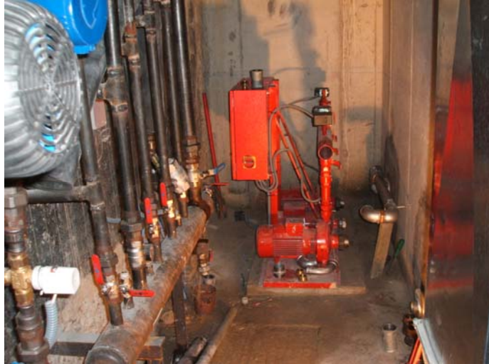
Col·lectors de la climatització, i bombes contra incendis, presentades sobre la seva bancada.
