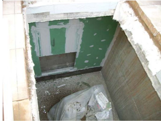
Interior del generador. Mur de pladur interior que separa la cambra de l'àmbit de la reixeta. Al fons de la cambra, hi ha un canal de recollida d'aigua.
