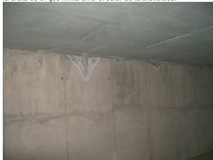
Humitats i eflorescències al sostre, que també baixen pel mur.
