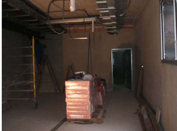
Instal·lacions a la sala del personal al soterrani (ala Sud).
