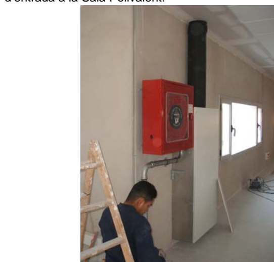
Instal·lació contra incendis i difusor per desplaçament al primer pis, abans de revestir amb pladur.
