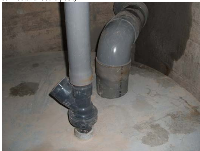
Tercer dipòsit, de fecals, però amb una entrada de pluvials des del pati.
