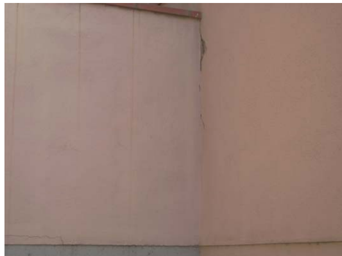
Petita esquerda a la trobada de murs. El mur de la dreta, és el límit amb el solar de la Biblioteca. Aproximadament a prop de la Biblioteca existent.
