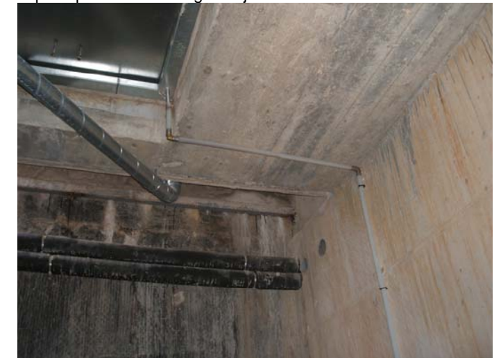
Tub de recollida d'aigua de la doble tapa de sobre del generador.
