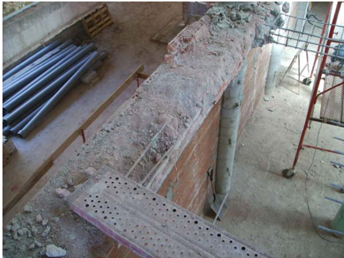
Estat de la riostra entre pilars
