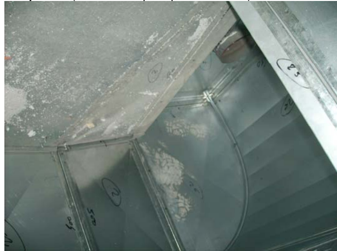
Detall de la connexió d'expulsió d'aire de la sala d'electricitat, a dins del tub d'expulsió d'aire de l'ala Sud (obsolet).
