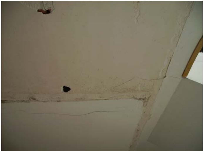
Esquerdas darrera de l'escala que encara no s'ha enderrocada.
