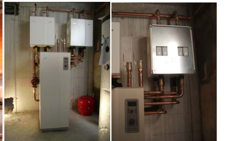
Bomba de calor geotèrmica NIBE aigua/aigua.
