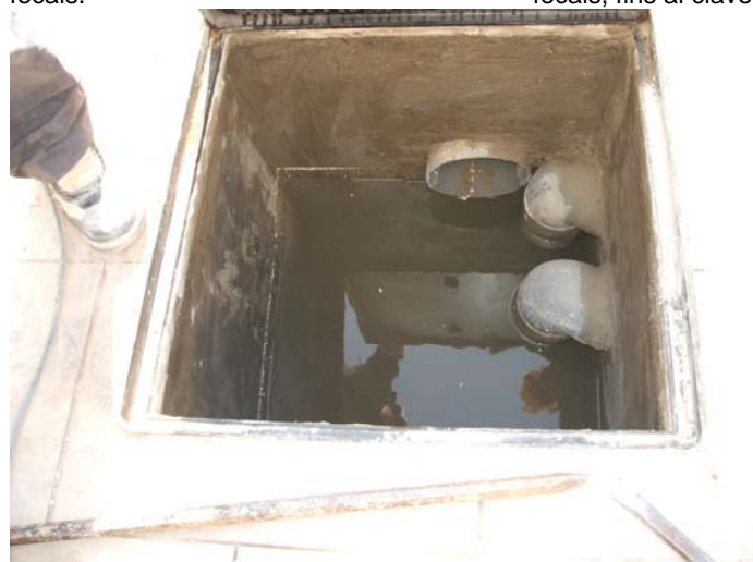
Arqueta principal i sortida cap al clavegueram del carrer. Aquí s'ajunten fecals i pluvials.
