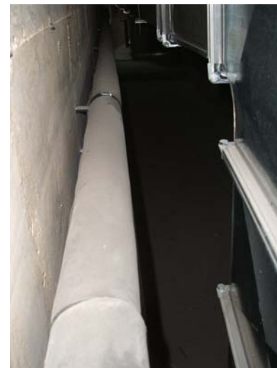
Recorregut dels tubs d'alimentació del climatitzador de l'ala Sud.
