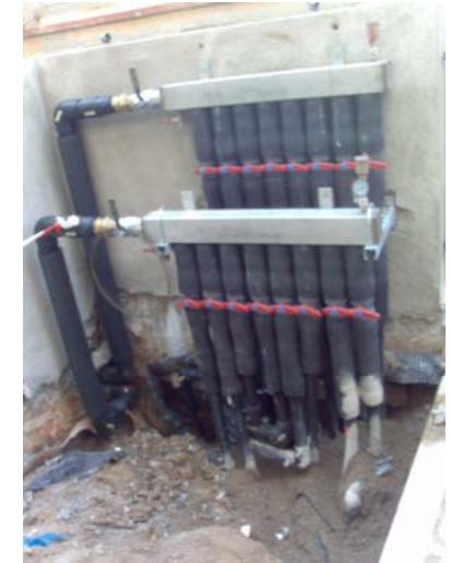
Col·lectors de l'armari dels pous geotèrmics.
