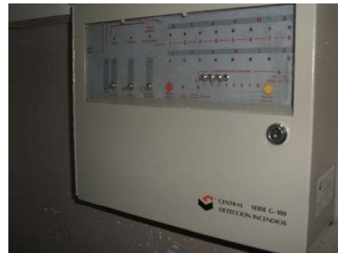
Quadre de detecció d'incendis al recinte de la electricitat.
