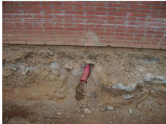
Escomesa elèctrica de la biblioteca antiga.
