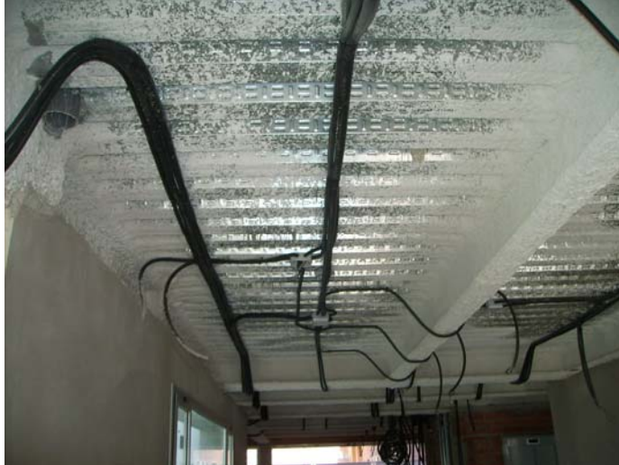
Sostre de Planta baixa. Instal·lacions elèctriques.
