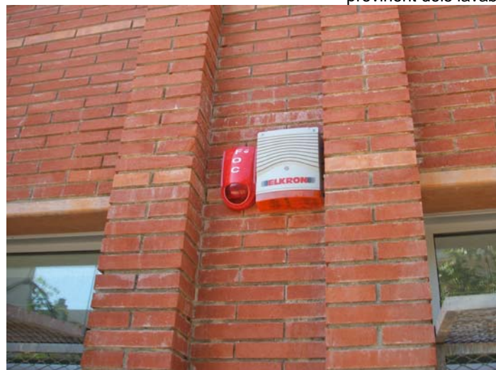
Aparells exteriors d'alarma, situats a l'edifici antic. Façana Sud.
