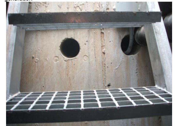
Escales d'accés al generador elèctric, i pas de les instal·lacions geotèrmiques.
