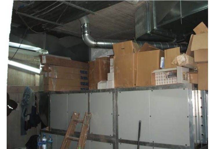
Climatitzadors al soterrani de l'ala Sud.
