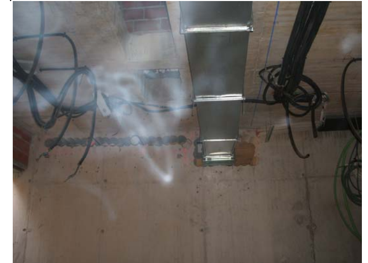
Retorn de l'aire de la sala polivalent cap al seu aparell d'aire. (a la sala de caldera)
