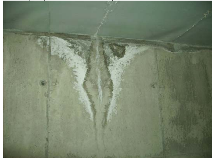
Humitats al sostre del garatge veí. Provocades per la seva pròpia piscina.
