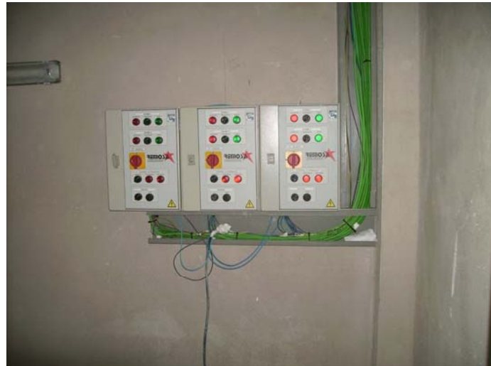
Quadres de comandament de les bombes dels dipòsits de sanejament. (sota l'escala principal al soterrani)
