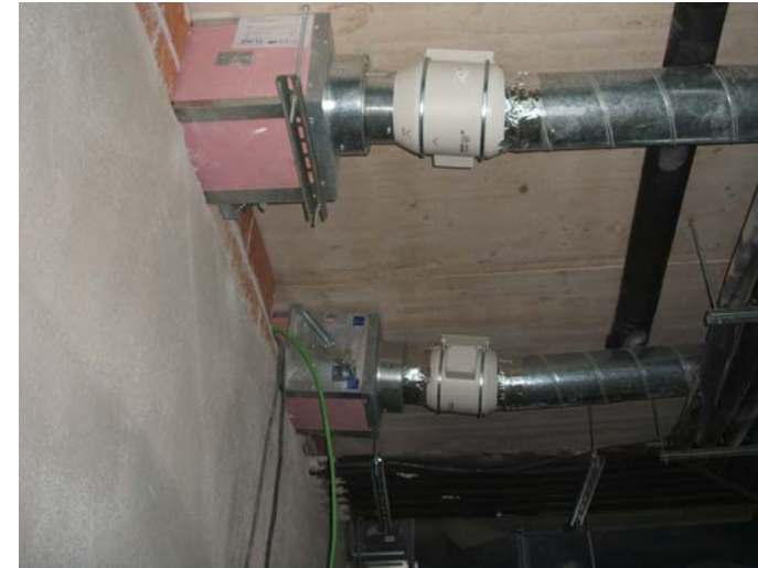
Extractors d'aire del recinte elèctric, i pas de tubs per la sala de climatitzadors del soterrani, ala Sud.
