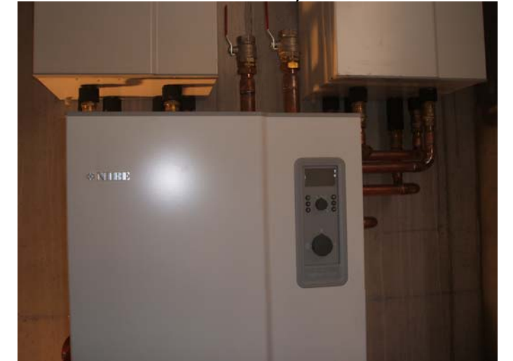
Bomba de calor geotèrmica NIBE aigua/aigua.
