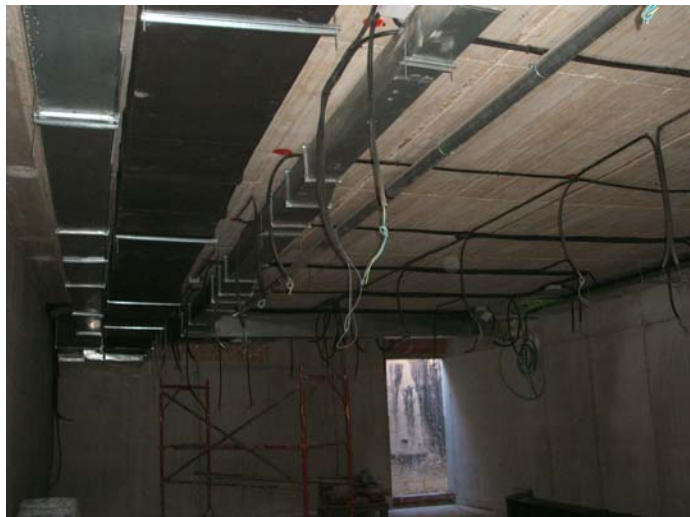
Instal·lacions d'aire condicionat, anada, retorn, elèctriques i
