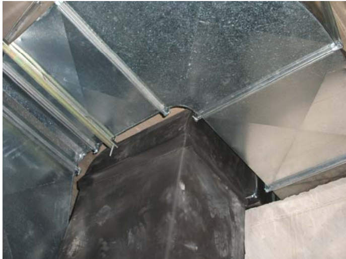
Sala d'aire condicionat de l'ala Nord. Connexió al fals sostre de la sala polivalent. (per a tota l'ala Nord)
