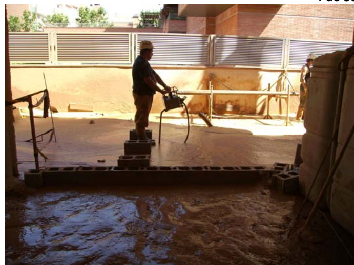
Inundacions de llots a l'ala Nord, degudes a la perforació dels pous geotèrmics. Els llots es recullen al recinte del generador.
