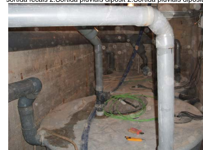
Vista de dos dels dipòsits de sanejament enterrats (tots de pluvials). A l'esquerra hi ha el pati central de la biblioteca. El tub de davant de tot és de fecals del dipòsit 3 (que no es veu)
