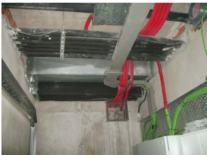
Pas de les instal·lacions de calefacció pel recinte de l'electricitat. Al fons, es veu l'entrada de les instal·lacions de telecomunicacions des del carrer.
