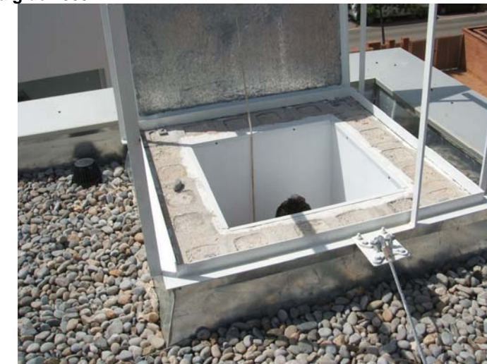
Tapa d'accés a la coberta. Amb baranes i línies de vida.
