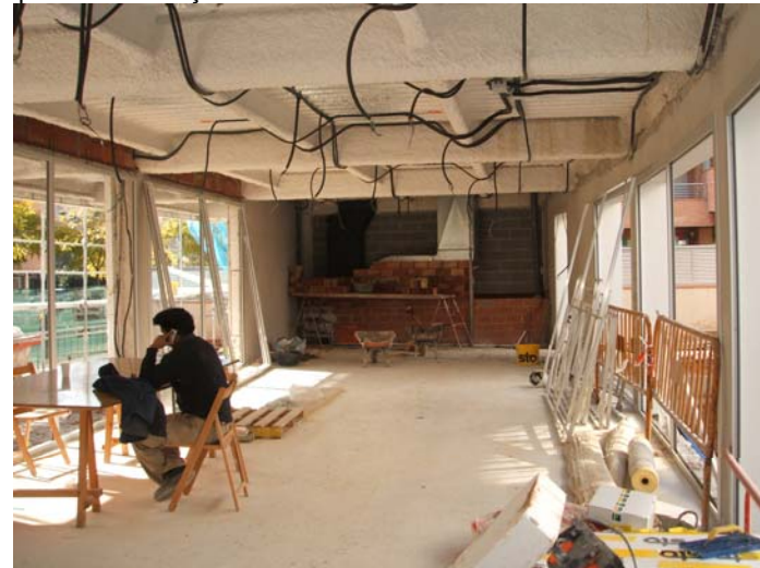
Estat de les instal·lacions, aire condicionat al fons, dins de la seva cambra. A l'esquerra, caixa del sòl radiant.
