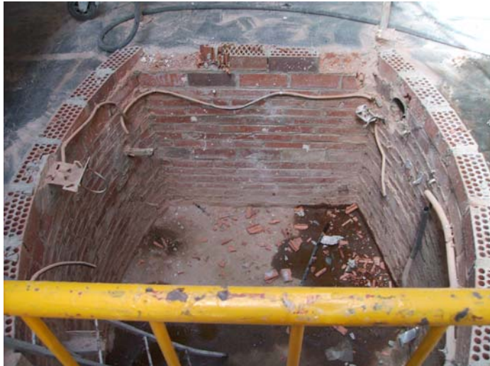
El pou de l'ascensor.
