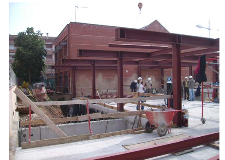
Jàsseres col·locades. S'observa un problema a la jàssera de la junta amb l'edifici antic. S'ha de corregir la seva longitud.
