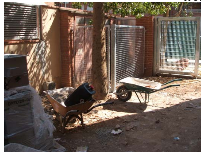
Nou recinte per als comptadors elèctrics, amb accés independent des del carrer.
