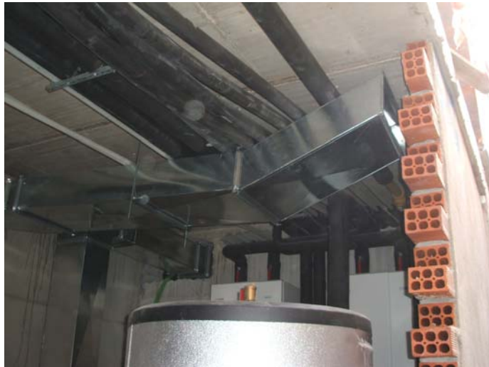
Conducte d'aire de l'aire condicionat de la sala polivalent. (sala de la caldera)
