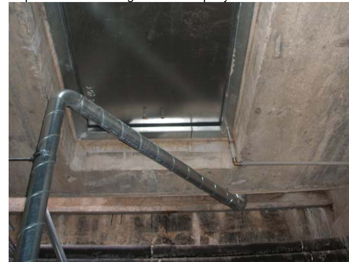
Xemeneia del generador. Sortida cap a la reixa d'expulsió de la ventilació
