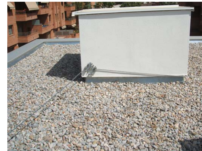
Línia de vida a la coberta de l'ala Nord. Anclatge.
