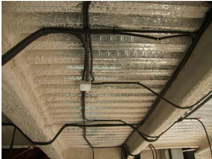
Sostre de planta baixa. Entrada. Instal·lacions elèctriques.
