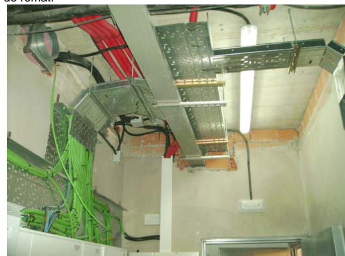
Una altra vista del sostre del recinte d'instal·lacions elèctriques. Al soterrani de l'ala Sud.
