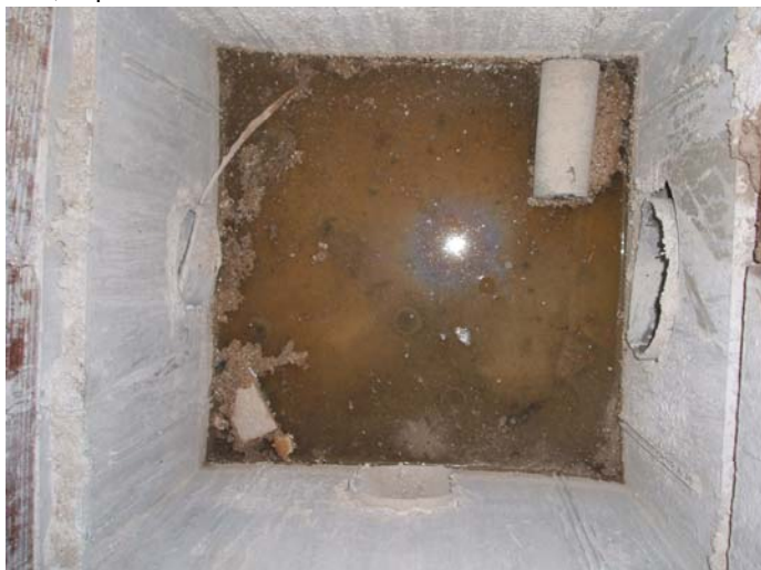
Interior de l'arqueta de la sala del climatitzador de l'ala Sud.
