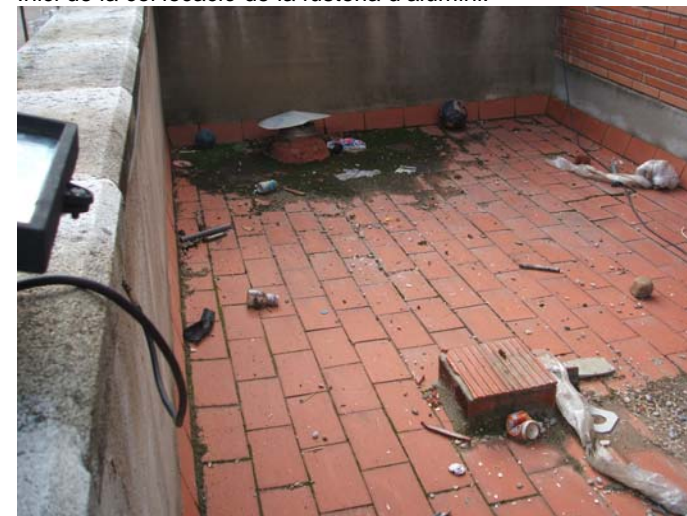
Un cop extrets els aparells d'aire condicionat de la coberta dels lavabos, es pot veure l'estat d'aquesta coberta.
