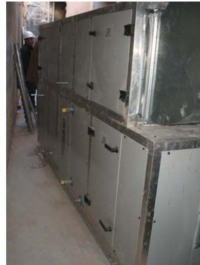
Sala d'aire condicionat de l'ala Nord. Màquines d'aire condicionat. (per a tota l'ala Nord)
