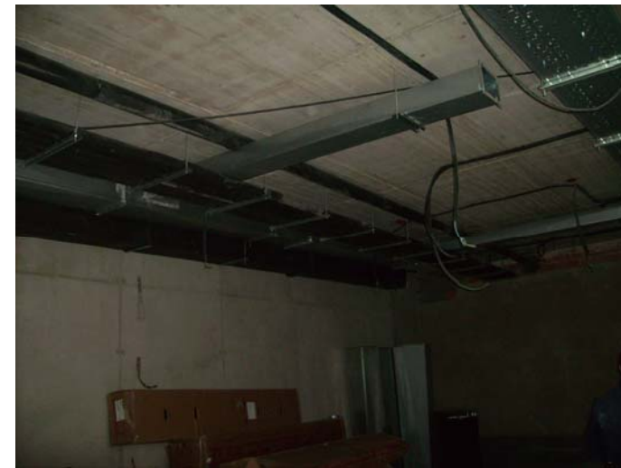
Instal·lacions al sostre de la sala de personal
