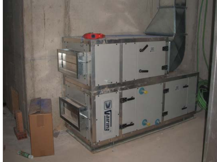
Sala de caldera i de la bomba geotèrmica. Aparells d'aire condicionat de la sala polivalent.
