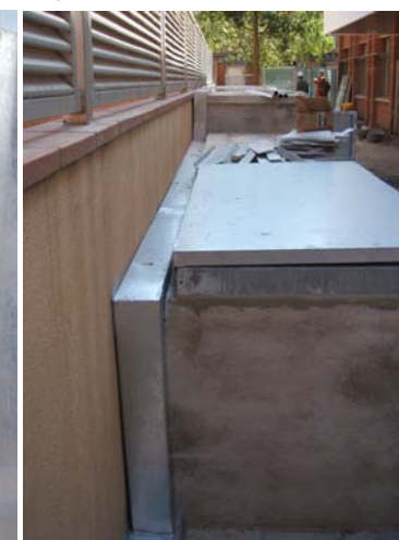
Remat de planxa de protecció del tub del gas, darrera de la tapa d'accés al generador.
