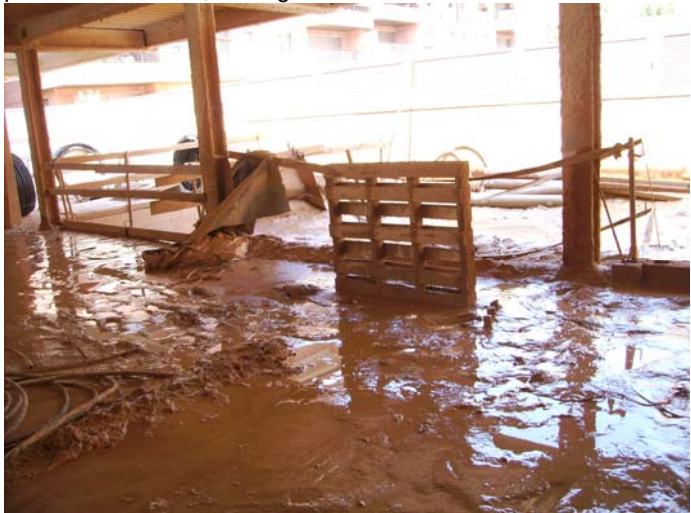
Continua la inundació de llots per la realització dels pous geotèrmics, a Planta Baixa.
