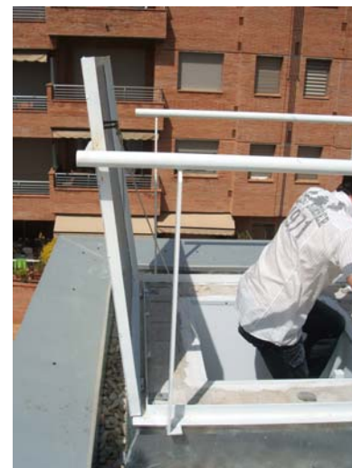
Tapa d'accés a la coberta. Amb baranes i línies de vida.
