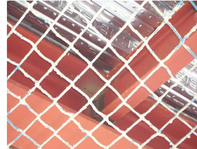
Manquen les platines que donen continuïtat a les corretges.
