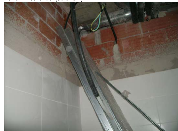
Pas d'instal·lacions per sobre del lavabo per a minusvàlids del soterrani (just sota de la entrada de l'edifici).
