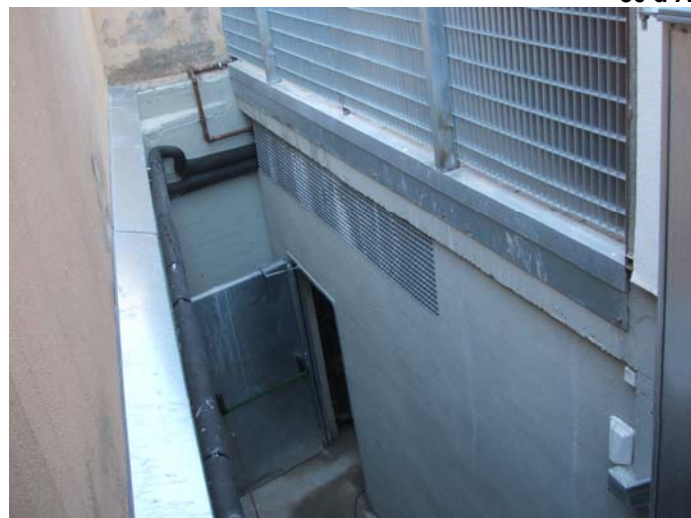
Pati d'instal·lacions a l'ala Nord.
