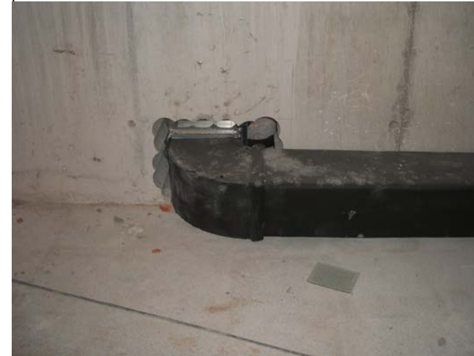
Sortida a nivell de terra de la impulsió d'aire a la sala polivalent. (procedent de la sala de la caldera)
