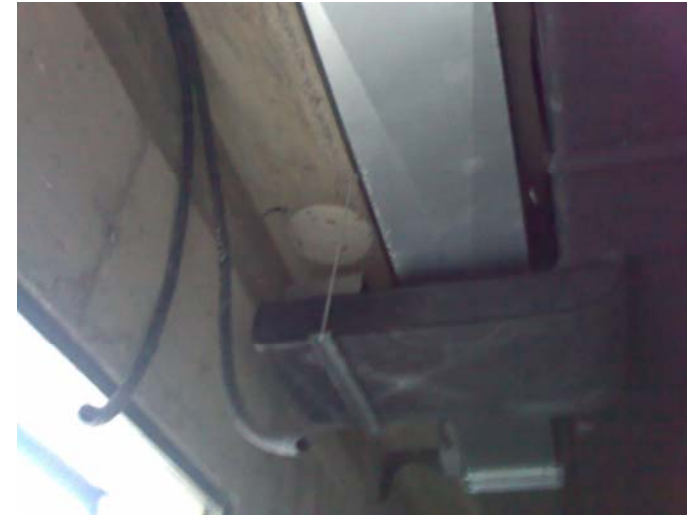
A la instal·lació d'aire del sostre, s'han invertit uns tubs. Els d'impulsió dels impulsors de planta baixa, han de passar per sobre del tub de retorn. S'ha usat un tub molt pla.
