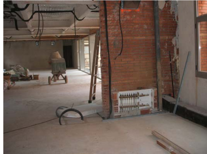
Tub negre, d'impulsió d'aire condicionat des del muntant de la fotografia anterior. Caixa del col·lector del sòl radiant.
