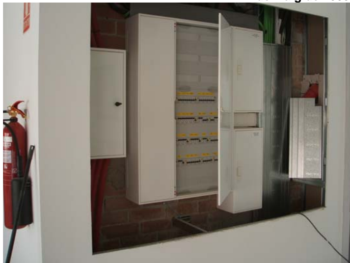
Quadre elèctric de planta baixa.
