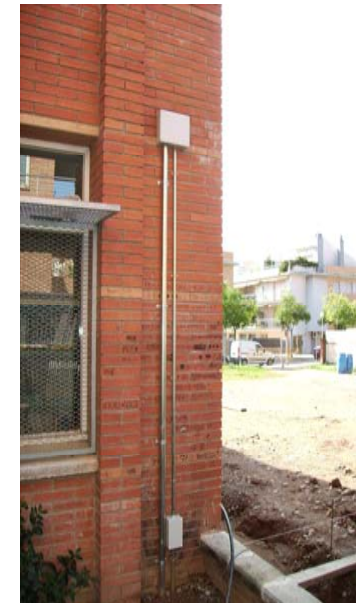
Instal·lació elèctrica provisional que permet el funcionament de la Biblioteca al mateix temps que el desenvolupament de les obres.
