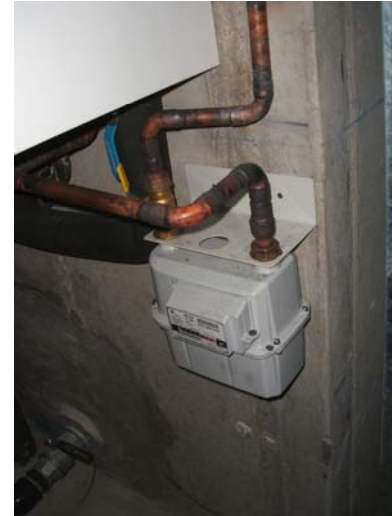
Comptador de gas al recinte d'instal·lacions (duplicat)
