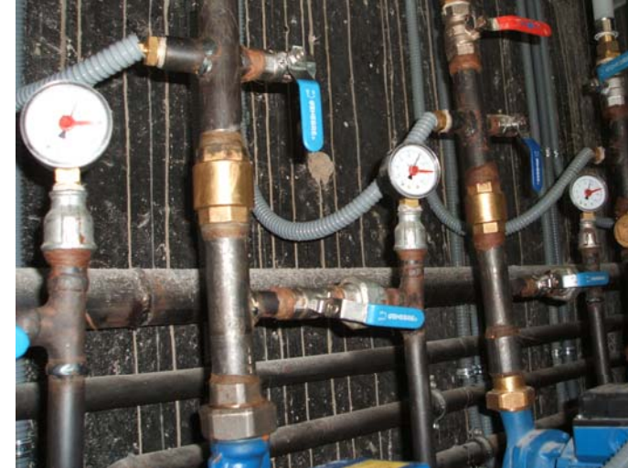
Manòmetres de les diferents bombes de climatitzadors i terra radiant.
