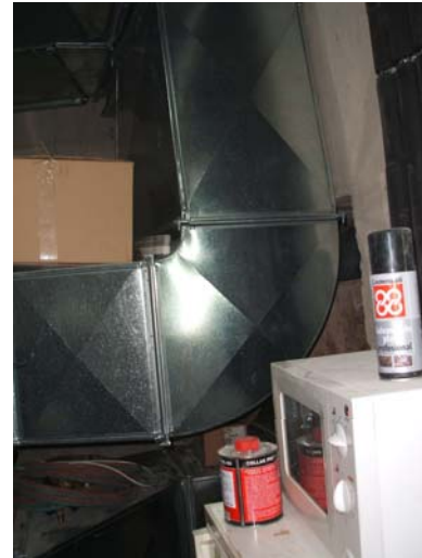
Conducte d'aire de l'aire condicionat de l'ala Sud. (sala tècnica del soterrani)
