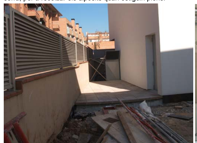
Pati interior. Tester de l'ala Nord, admissió d'aire del climatitzador de l'ala Nord.
